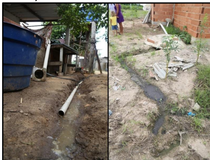
Figura 7 - a) Disposição de águas cinzas em quintal, sem qualquer proteção; b) Extravasamento de efluente de fossa
